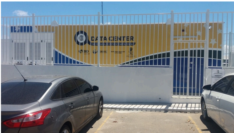
Container Cofre instalado
